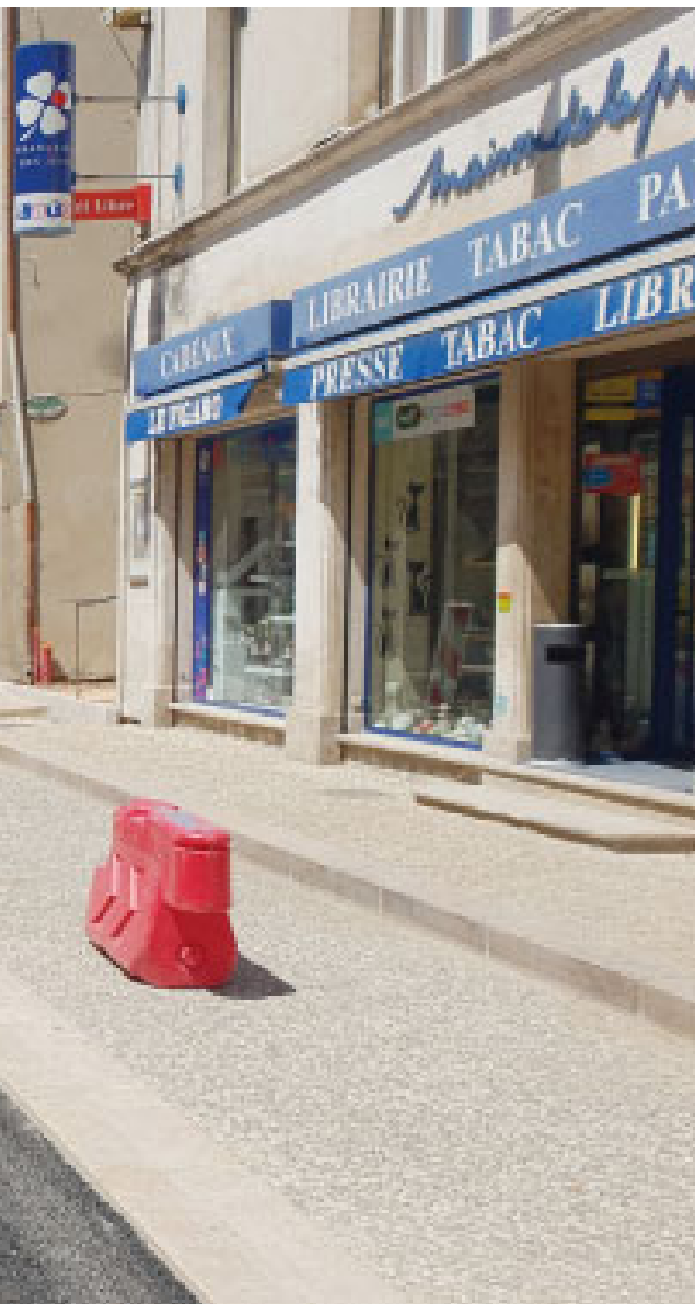
Le boulevard presque terminé, avant qu'il ne soit rendu aux voitures. Les automobilistes sont priés de ne pas se garer sur les trottoirs !
