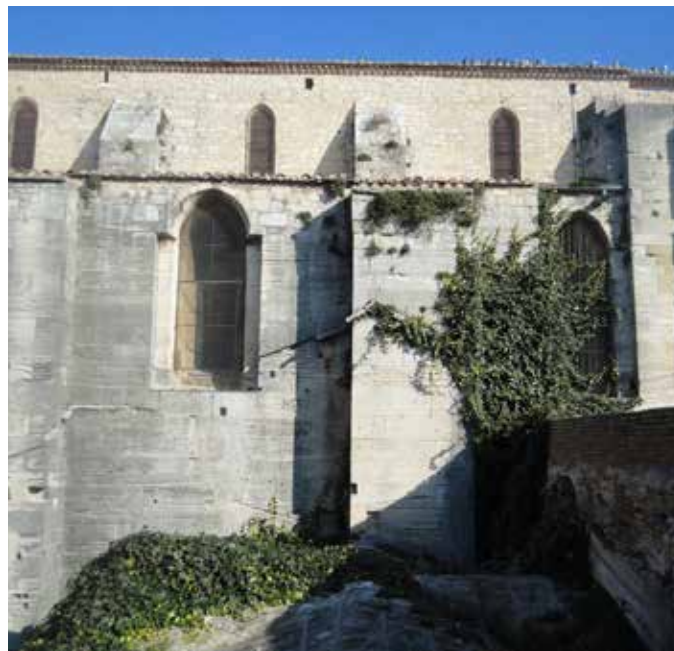
Bas-côté et contrefort de la nef envahis par la végétation
